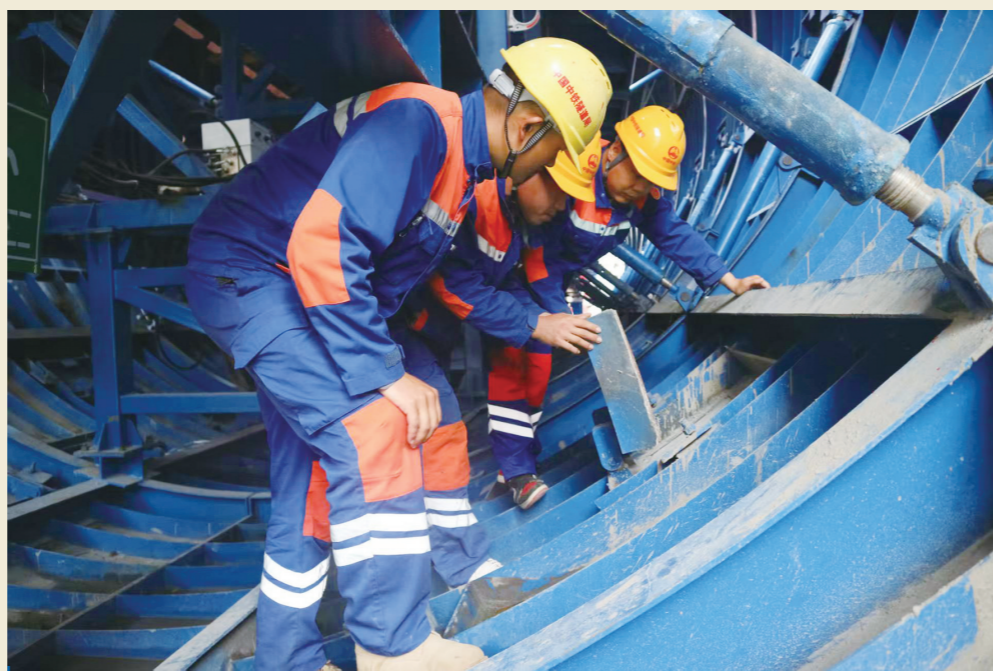
隧道股份滇中引水大理1段3标项目部青年团队“五一”假期坚守岗位，攻克极严重软岩大变形、高地应力、大体积混凝土浇筑质量控制等施工难题。因为技术人员在福福村渡槽模板浇筑前进行模板体系安全质量检查。杨良荣 摄影报道
