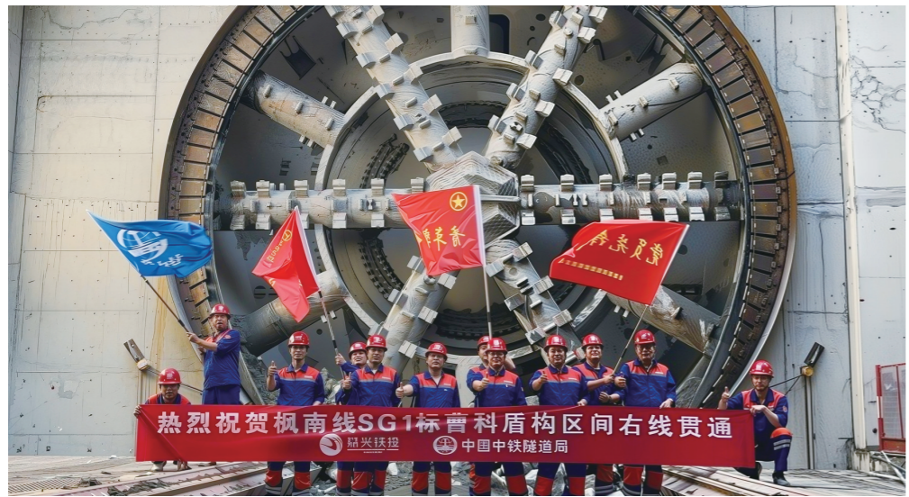
浙江嘉兴消息 5月6日，一处施工的嘉兴市域铁路项目再迎重大节点——曹庄至科技城右线盾构区间右线隧道安全贯通。嘉兴至枫南线是嘉兴市域铁路的核心组成部分，全长35.1千米，共设8座车站，此次贯通的曹庄至科技城区间右线全长约2.6千米。隧道地处长三角冲积平原，沿线富水软土分布广泛，接收并紧邻河道，盾构主线路区域地下管线繁杂，周边建筑物密集、地质条件复杂，对盾构掘进姿态、地层沉降及施工安全提出极高要求。
